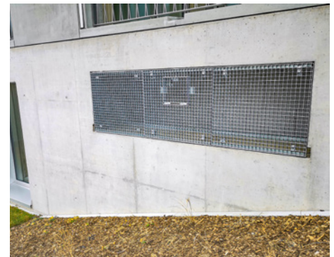
Stehender Gitterrost mit Umlenkrolle: Blick von aussen.
