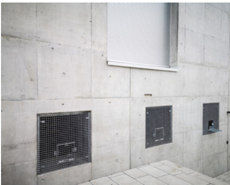
Stehender Gitterrost: Blick von aussen mit Klappe nach oben geschwenkt und arretiert.
