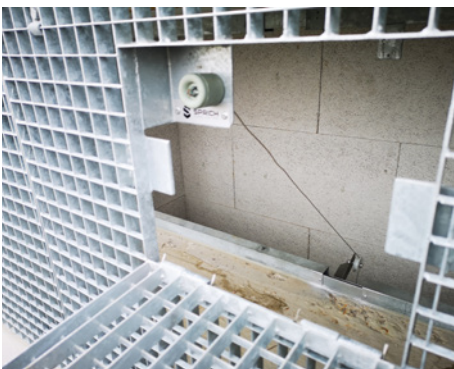
Stehender Gitterrost mit Umlenkrolle: Über die Umlenkrolle und den Seilzug lässt sich die Rauchklappe einfach schliessen.
